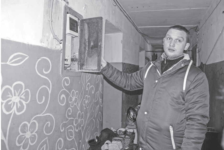
Электросчетчик в квартире не работает - считать киловатты здесь невыгодно
